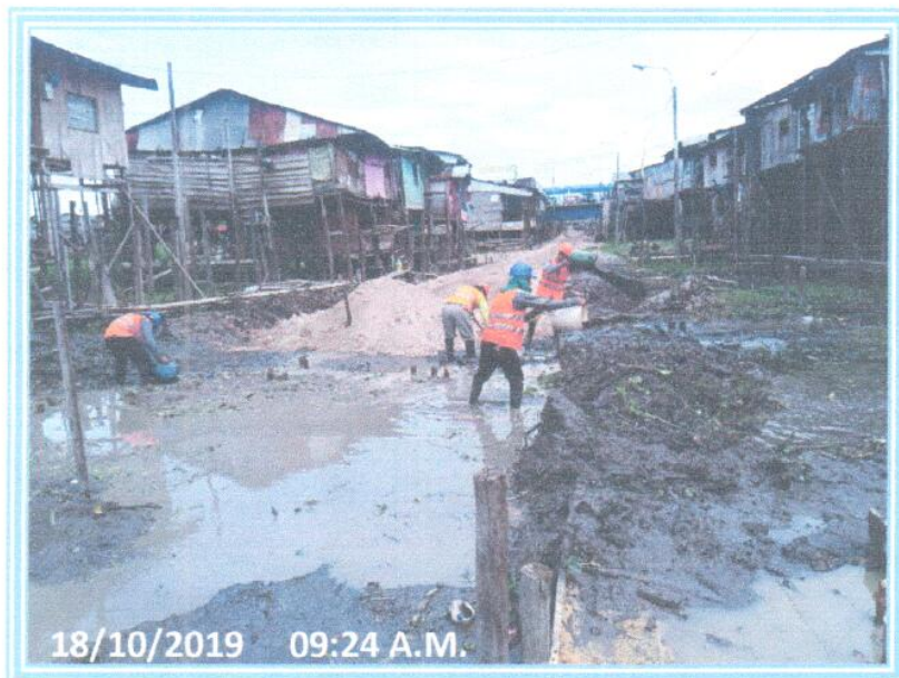
Foto 6: Se aprecia los trabajos de limpieza de la zona de trabajo y el acopio de Material de Relleno.
