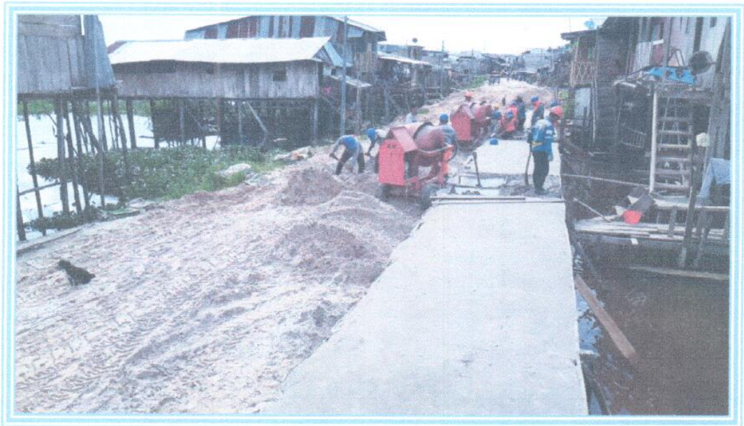
Foto 08: Se observa los trabajos de mezclado de C:A- 1:10 para la elaboración de mortero, vaceado en las bolsas Big Bag y acabado.
