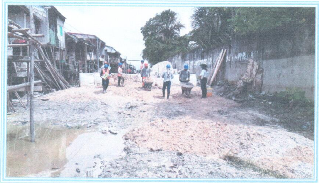
Foto 07: Se observa al personal obrero en los trabajos de transporte de material de relleno con ayuda de las carretillas.
