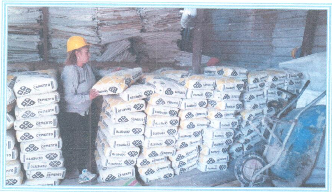
Foto 13: Se observa a la Almacenera en sus funciones, acomodando los materiales del almacén de obra.
