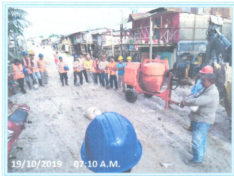
Foto 04: Se aprecia la reunión de inicio de Obra en presencia del Residente, Personal Administrativo y Obrero.
